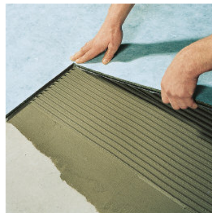
3. Montera PCI Polysilent skivorna och pressa ner dem ordentligt. Skivorna skall läggas med den ljusa sidan uppåt. Lägg skivorna tätt intill varandra. Fästmassan får inte pressas upp mellan skivorna.
